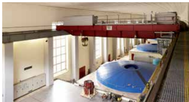
Blick in die Kraftwerkshalle
